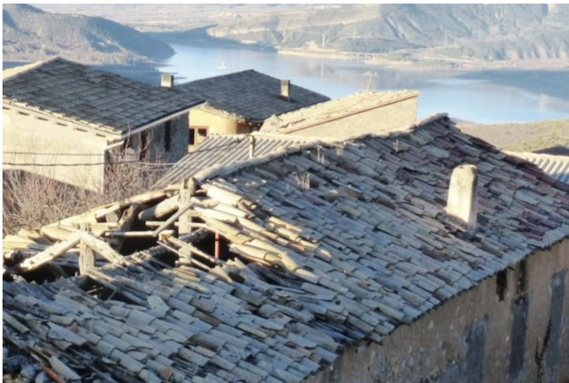
Les antigues escoles de Pessonada es troben en molt mal estat. Foto: CCPJ
