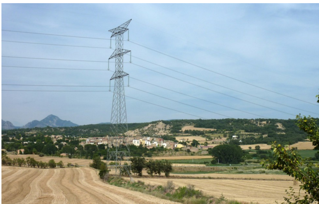
Una torre elèctrica a prop del poble de Figuerola d'Orcau | ACN
