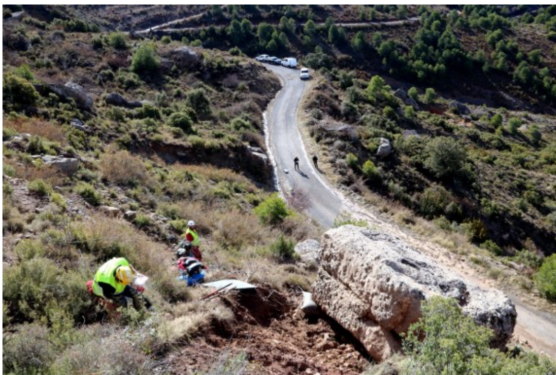
Pla general de la roca que amenaçava de precipitar-se a la carretera d'Hortonedà. Foto: ACN
